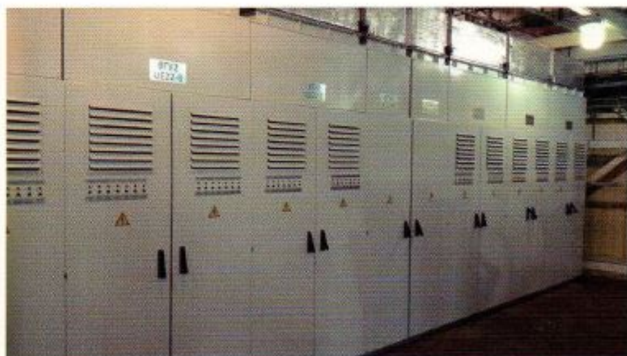
Рис. 2. Общий вид ТПЧ-10/25000, установленного на компрессорной станции «Павелецкая»
