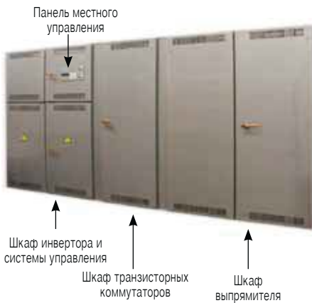
Рис. 9. Шкафы для размещения оборудования преобразователя частоты ВПЧС
