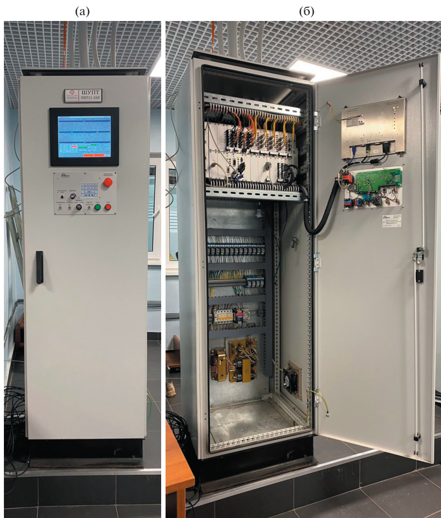
Рис. 7. Внешний вид шкафа управления источником тока: а – вид снаружи; б – вид изнутри.
