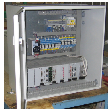
Рисунок 5 – Внешний вид шкафа СУРЗА
