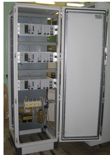
Рисунок 4 – Внешний вид шкафа управления фазами
